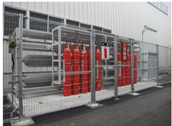
圧縮水素容器・圧縮機・蓄圧器
