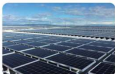
太陽光発電設備
